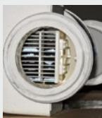
Filtre de piscine
