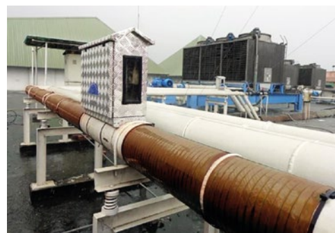
Vulcan S500 se trouvait dans un boîtier en aluminium installé sur l'une des conduites principales de la tour de refroidissement dans Supermal Karawaci.
