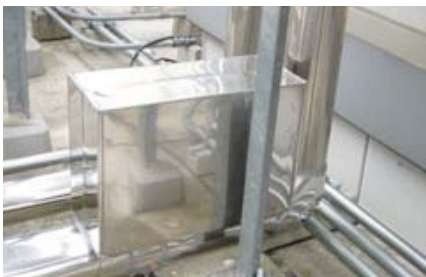
Vulcan S25 a été installé sur la conduite d'eau approvisionnant les tours de refroidissement A, B et C.
