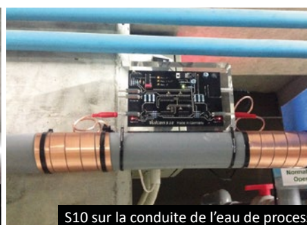
Bandes à courant d'impulsion protégées par le revêtement isolant de la conduite
