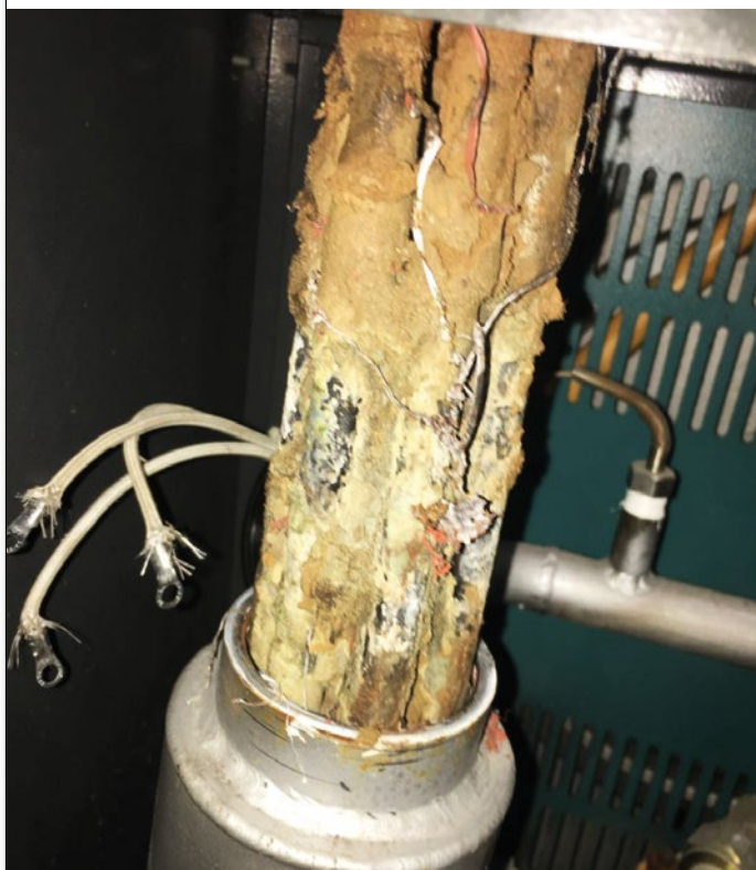
Échangeur de chaleur non traité pendant 3 ans.
