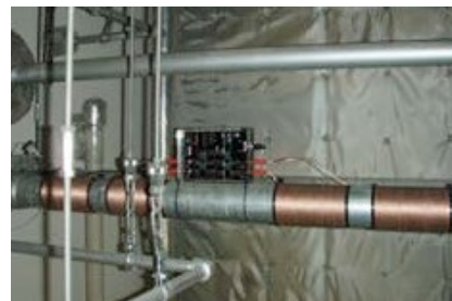
Vulcan S25 a été installé sur la conduite d'eau de circulation de la tour de refroidissement C.
