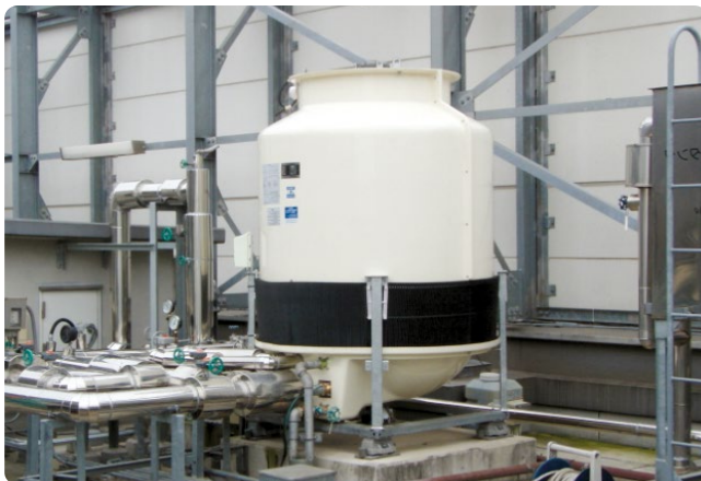
Tour de refroidissement
