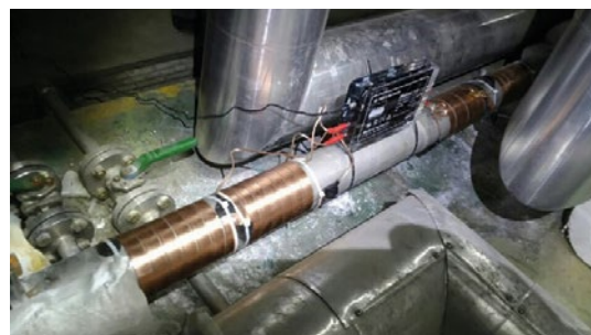
Vulcan S25 installé chez Toray Industries
